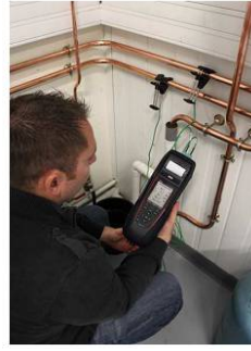
Temperatura de la red de agua caliente doméstica
